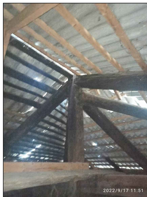
Вид в осях Б-А, 2-3. Неплотности в местах соединения асбестоцементных листов, в местах соединения конька, сколы, трещины. Плохое закрепление листов к обрешетке.
